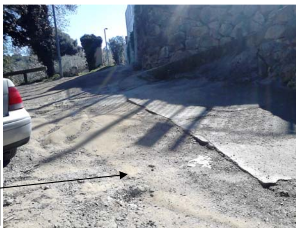
Accés a la pista malmès, des del C/ de les Creus
