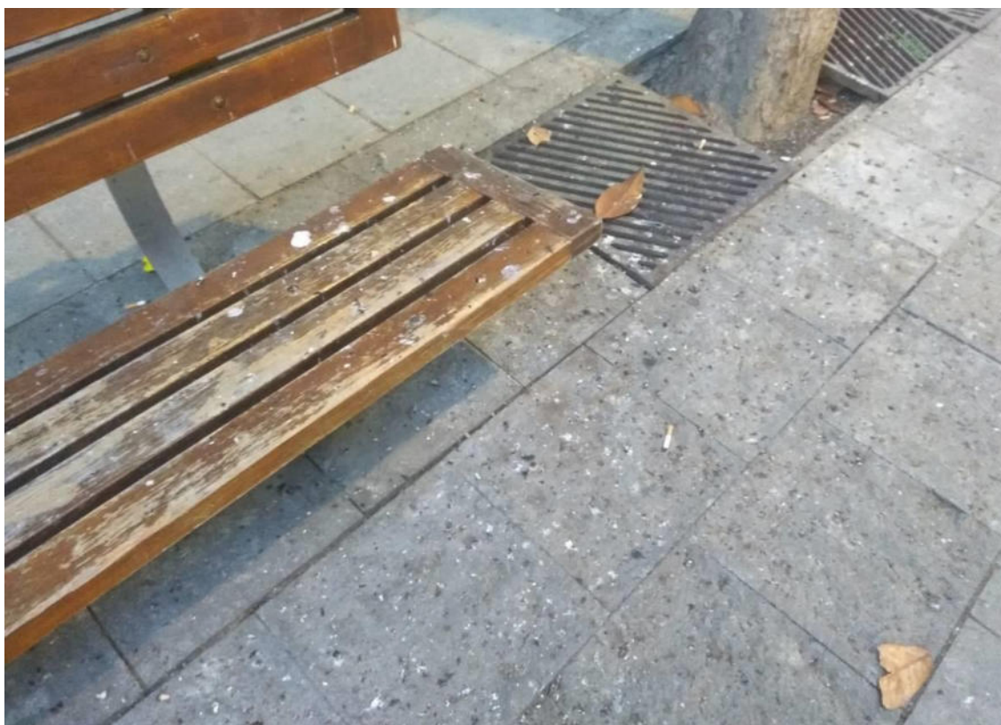
Dormidor nº7. c/Santa Clara. Afectació per defecacions.
