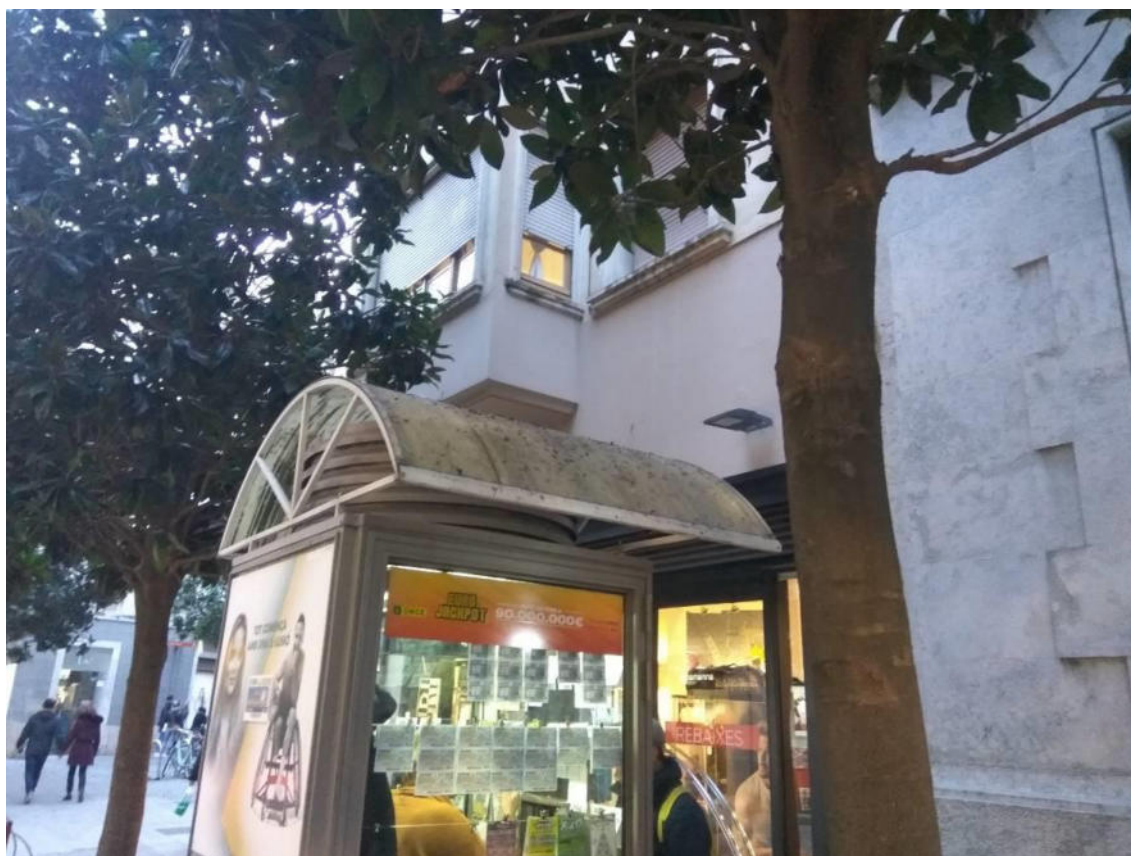
Dormidor nº7. c/Santa Clara. Afectació per defecacions.
