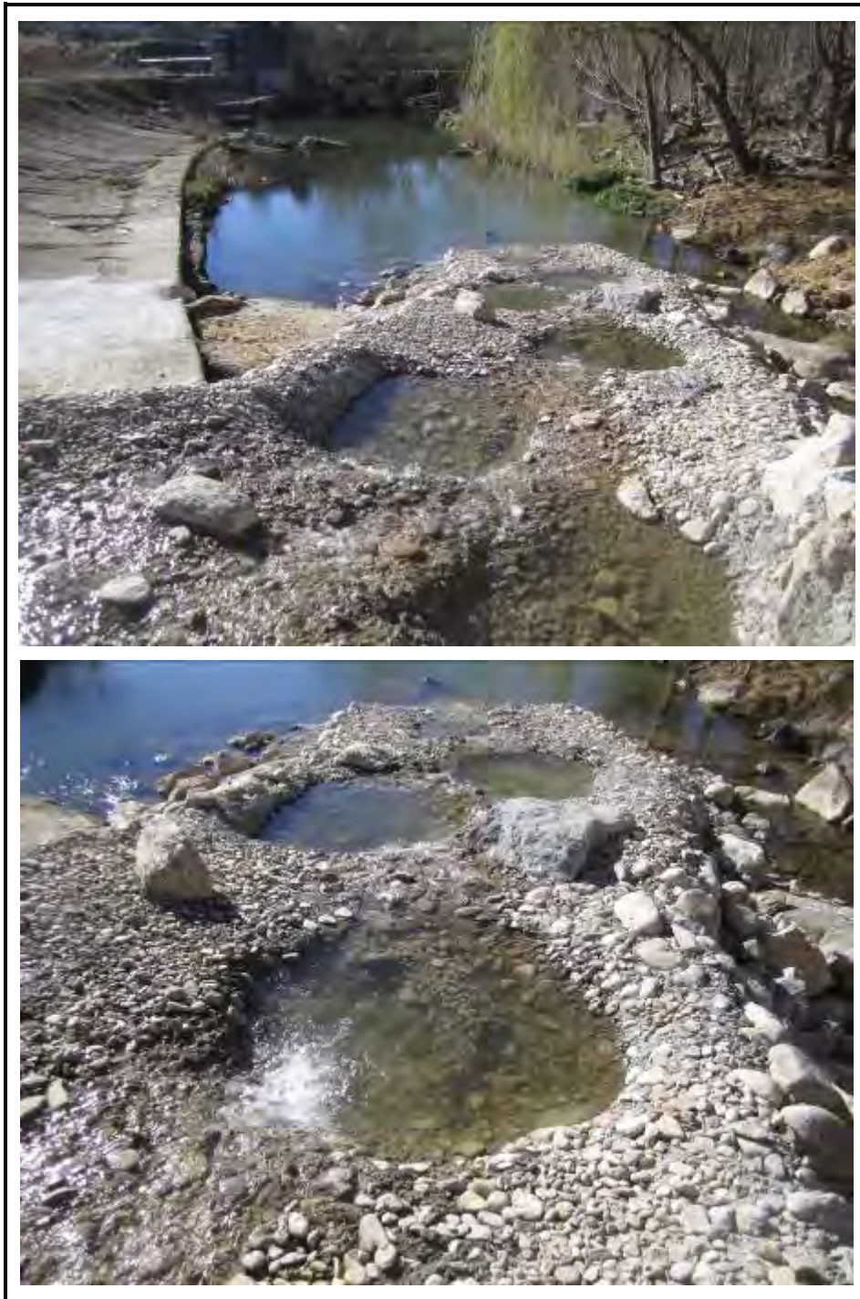
Figura 17-B.- Exemples de permeabilització de barreres (resclores) mitjançant rampes per a peixos: nova rampa per a peixos a la resclosa de Can Torres (Barrera T1). Es tracta d'un disseny que incorpora diverses cubetes de descans consecutives al llarg d'una rampa. Les fotografies s'han pres en una situació de cabal baix (per sota el cabal de manteniment establert per aquesta tram del Ter). S'observen possibles problemes d'execució de l'obra, sobretot a l'entrada superior, que en poden condicionar la funcionalitat real. Fotos: Sorelló.
