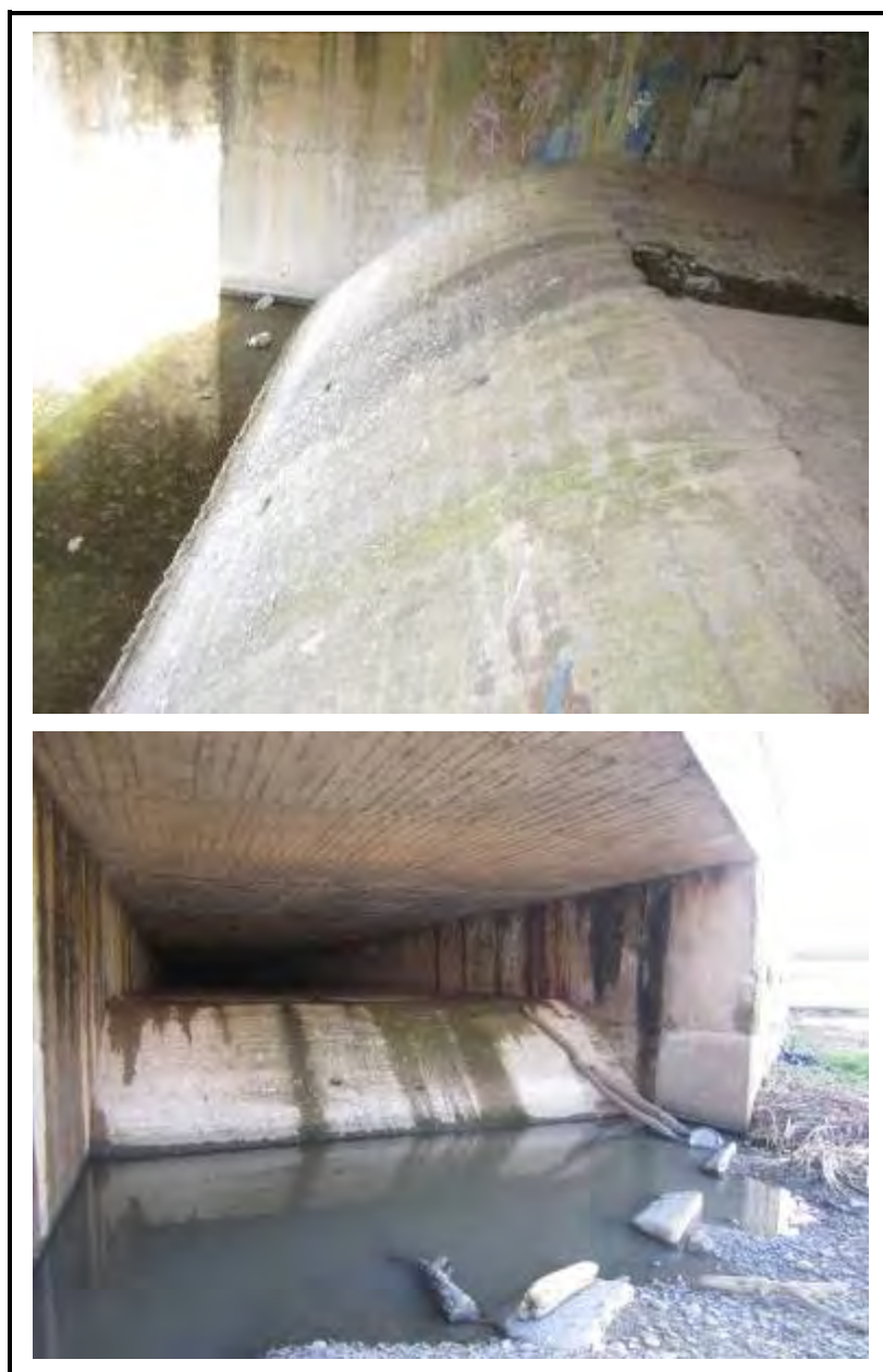
Figura 8.- Imatges del salt d'aigua existent a la desembocadura del Galligants a l'Onyar (Barrera G1). Fotos: Sorelló.
