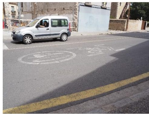
Imatge 16. Senyalització horitzontal de circulació de bicicletes en calçada en mal estat.
