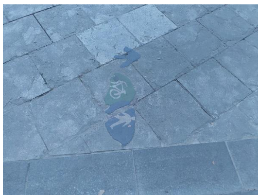
Carrer Santa Clara, senyal horitzontal Vies Verdes desgastat
