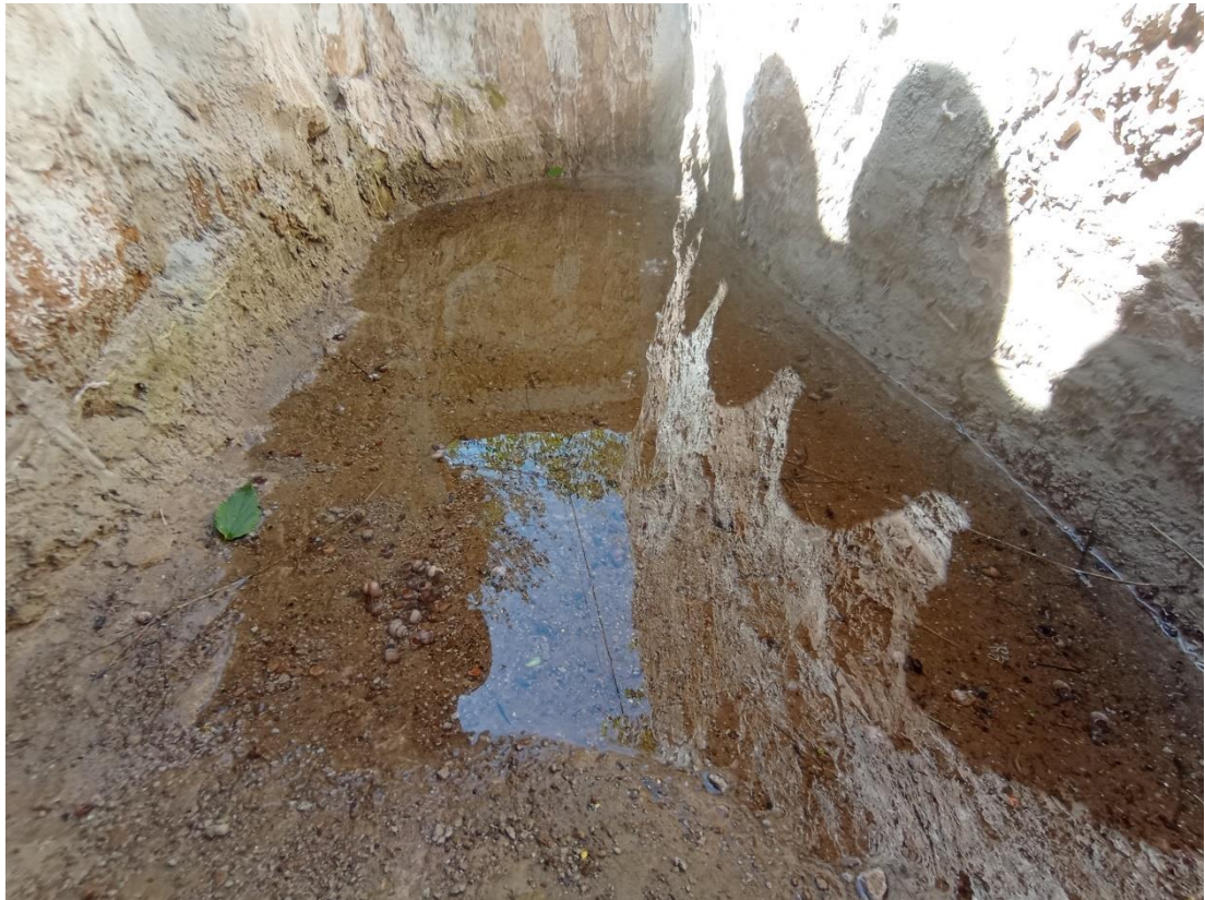
Figura 10: Abrevadero restaurado y con la construcción del tejado para canalizar la escorrentía
