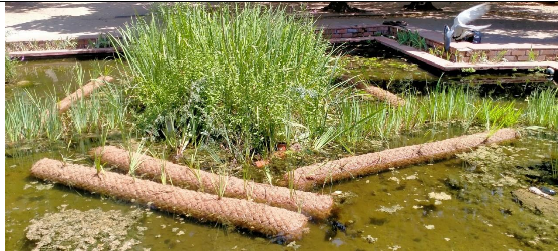
Figura 92: Biorrollos de fibra de coco colocados a la espera de la llegada de los bloques y piedras.
