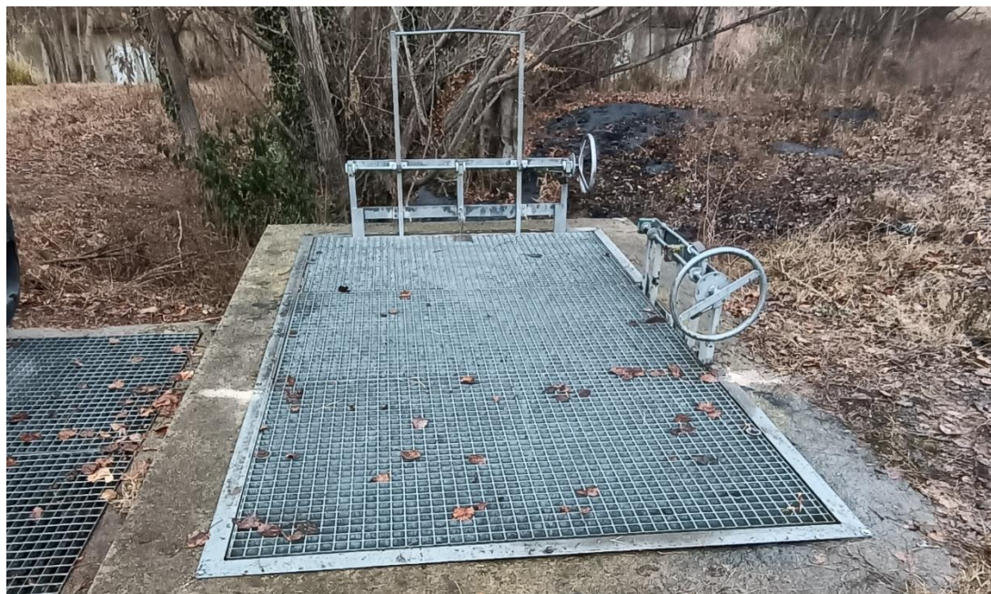
Figura 2. Arqueta en la que irá instalado el filtro de gravas. Esta arqueta dispone de dos compuertas que posibilitan desviar el agua hacia la charca o bien directamente hacia el río Ter.
