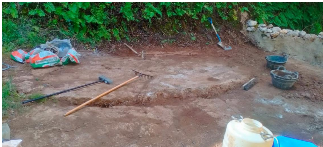
Figura 12. Se limpia completamente la roca y se empieza a impermeabilizar el muro..
