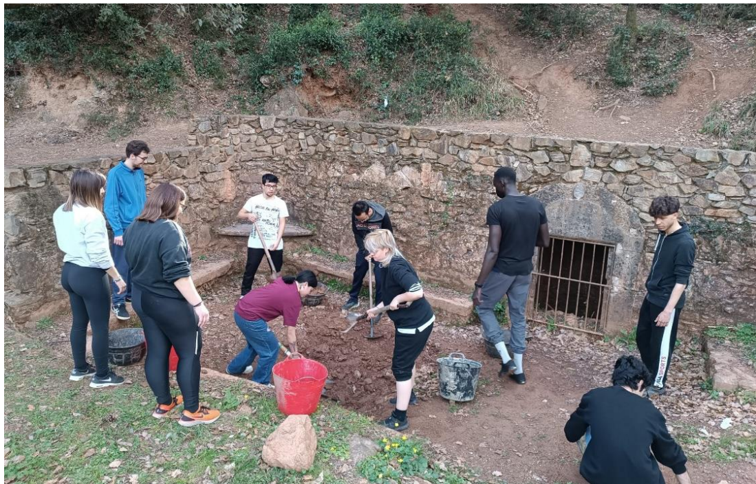
Figura 4. Técnicos de Sorellona y voluntarios de la entidad trabajando en la excavación de la cubeta.
