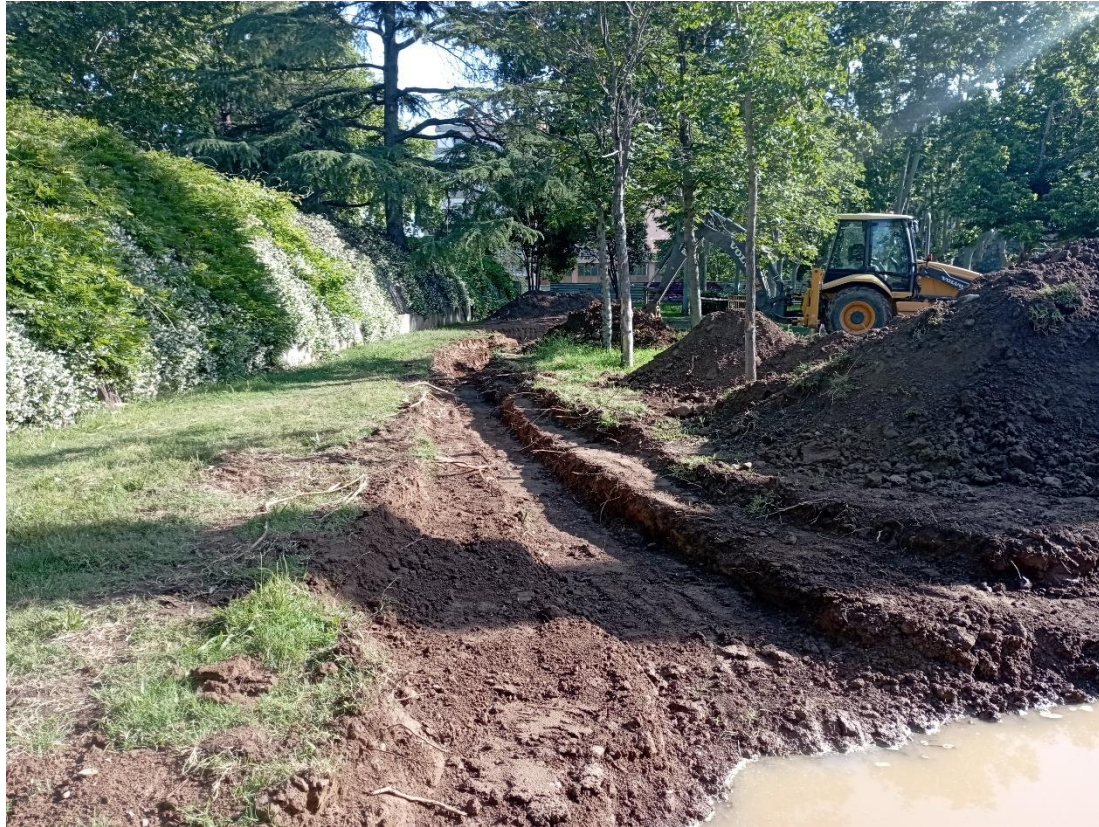
Figura 12. Zanja de salida de agua de la charca 1 del Parc Migdia, en direcció a la charca 2.
