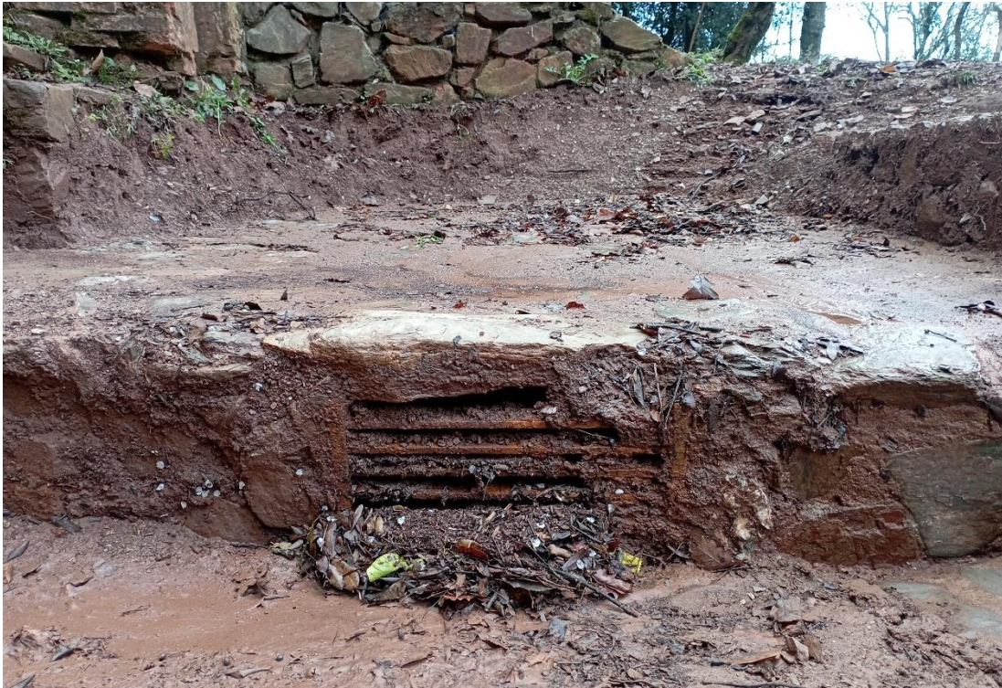
Figura 6. Una vez retirados todos los sedimentos se ha encontrado una antigua estructura con una reja que parece ser un desguace del agua.
