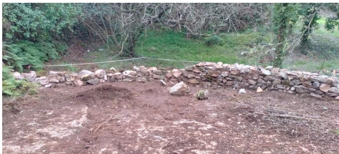
Figura 10. Muro en construcción, día 27 de marzo de 2024. Se aprecia cómo se está dejando la roca madre a vista para que corra mejor el agua, quitando la fina capa de materia orgánica acumulada con los años.
